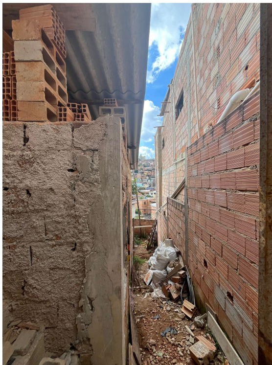
Acesso ao imóvel, no dia 10/04/2024. Fonte: acervo da equipe.
